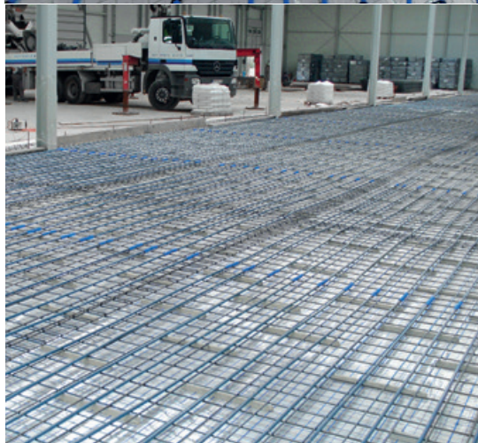
Pav. 4. Grindinio šildymo sistema sandėliavimo patalpoje, naudojant PE-RT Blue Floor ir KAN-therm NET Sistemos vamzdžius
